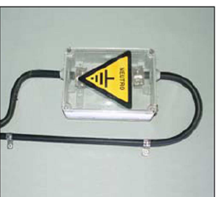
Caja de Seccionamiento de Servicio
