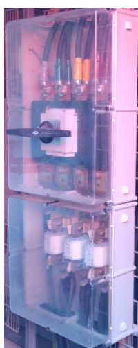
Figura 12. Interruptor en carga con fusible en la parte de baja tensión.
