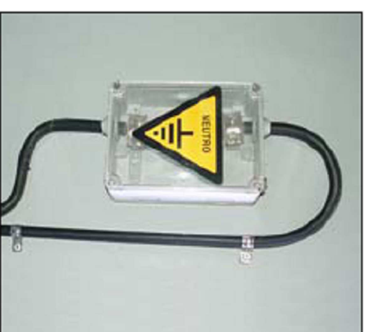
Caja de Seccionamiento de Servicio
