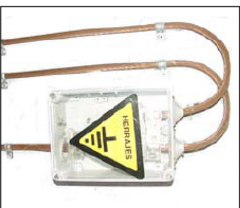
Caja de Seccionamiento de Protección
