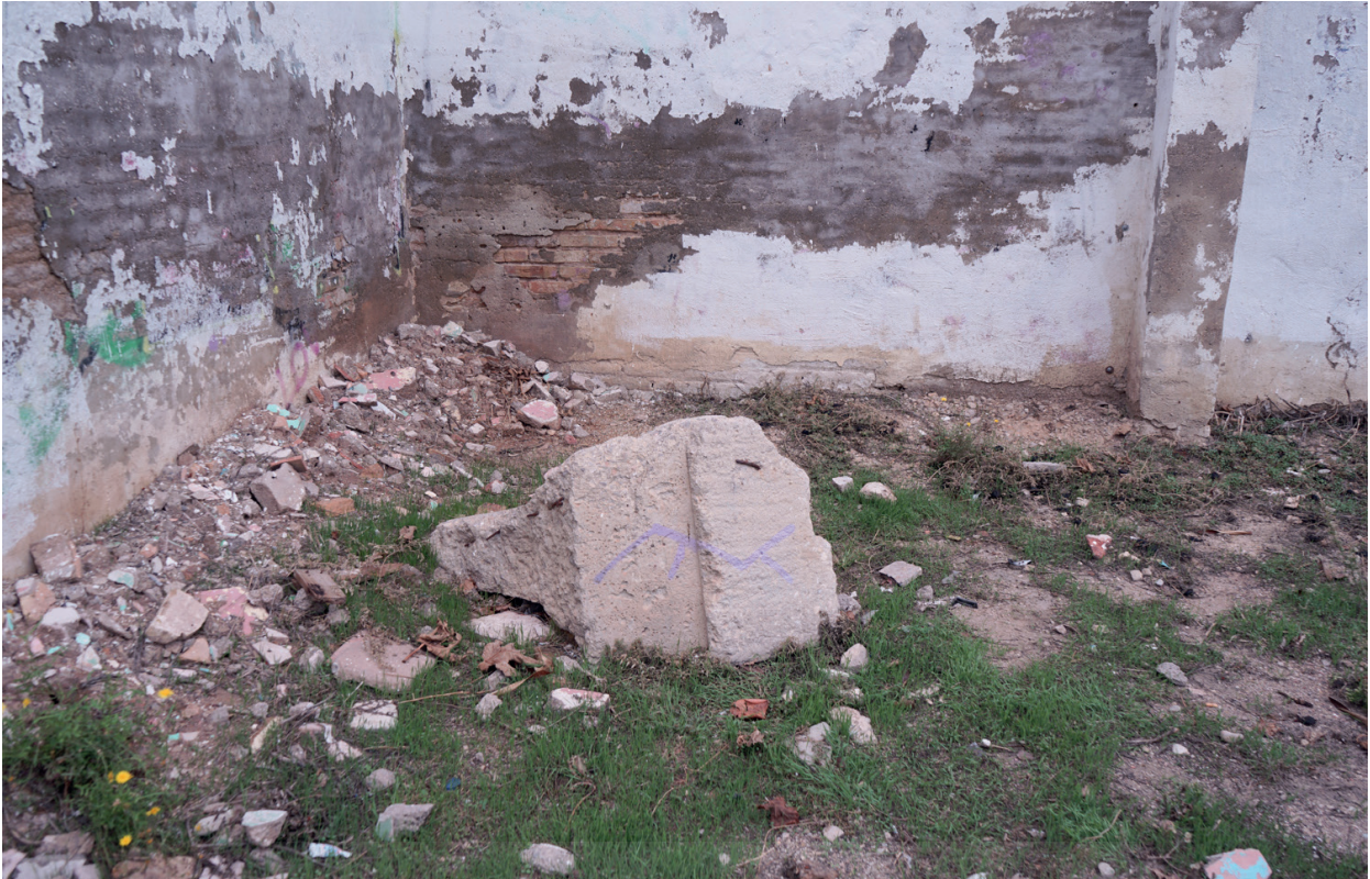
Fig 41. Restos de la vivienda ahora inexistente
