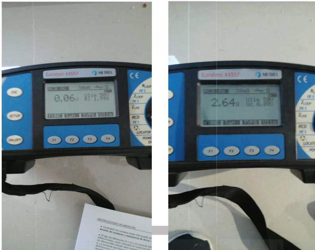
Fotografía 15. Detalle de la medición de la tensión de contacto y la resistencia de bucle/defecto.
