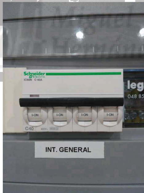
Fotografía 8. Detalle del Interruptor General Automático instalado. 40A (IV)
