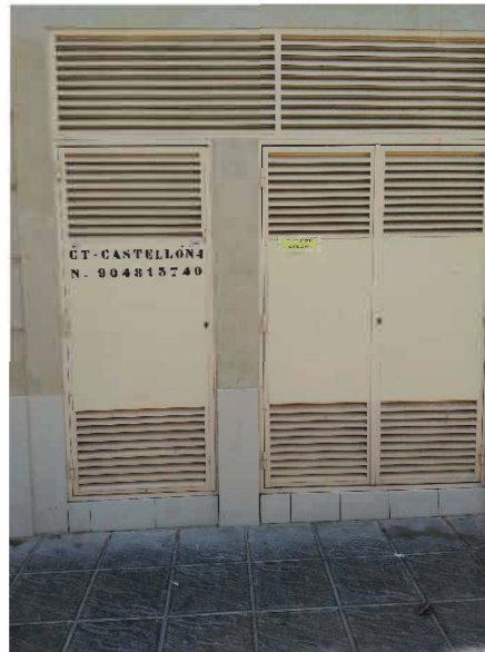
Fotografía 1. Centro de Transformación que alimenta al edificio y sus locales.
