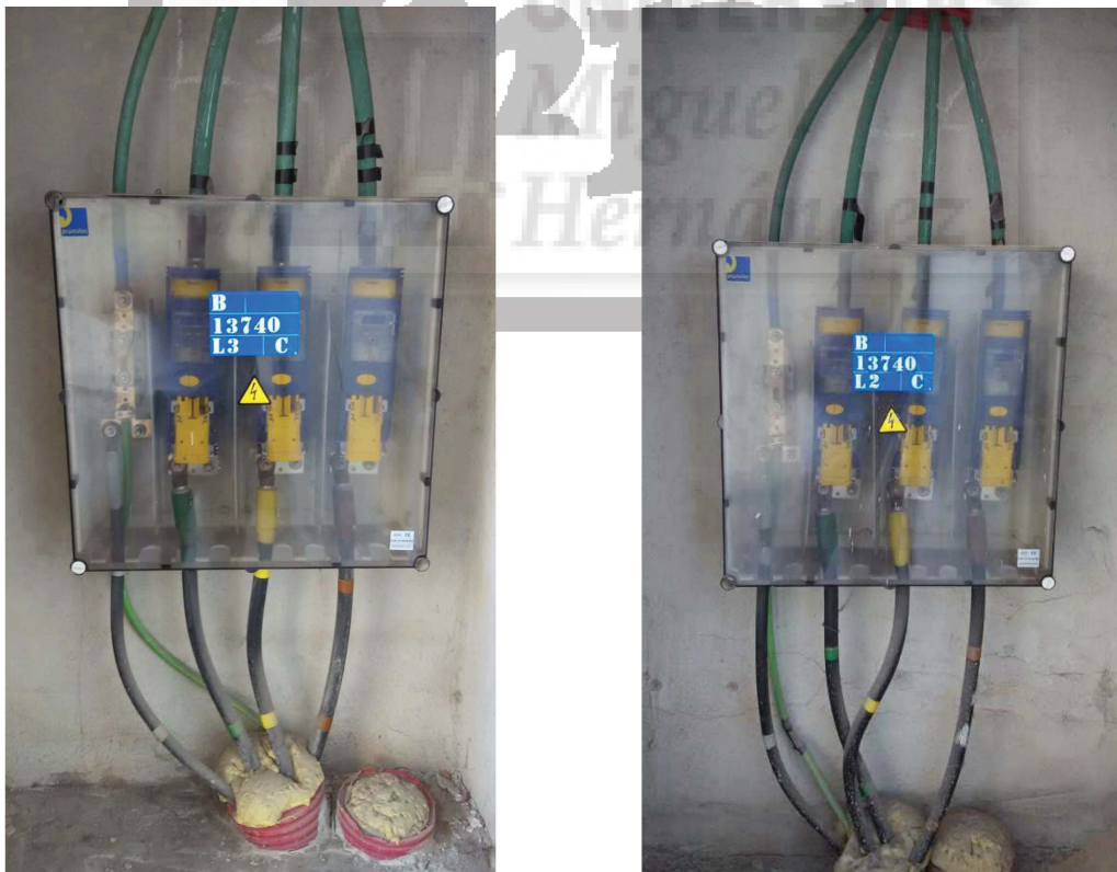
Fotografía 2. Detalle de las CGP que alimentan al edificio y a los locales. Fusibles tipo cuchilla 315A.
