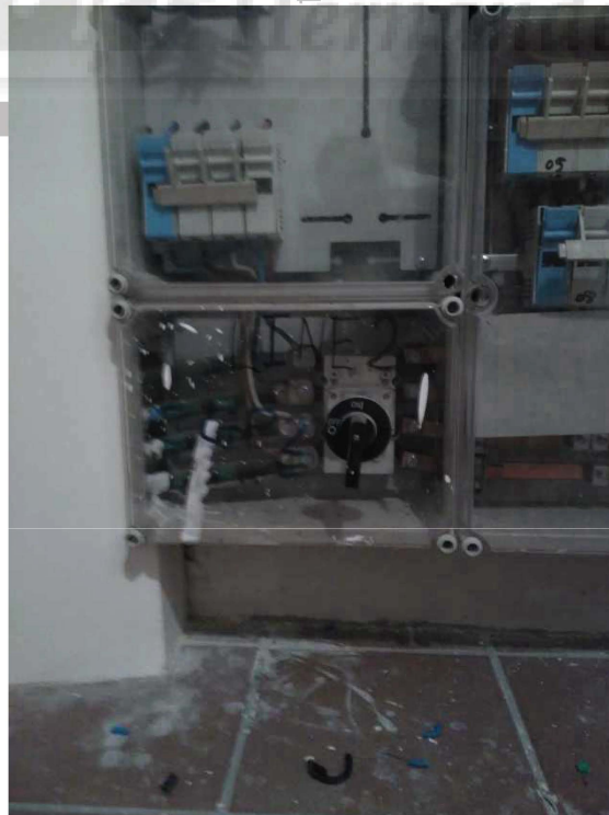
Fotografía 4. Seccionador de la centralización de 250A de calibre.
