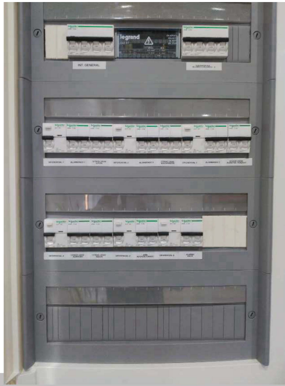
Fotografía 7. Detalle del cuadro general de mando y protección instalado en almacén.
