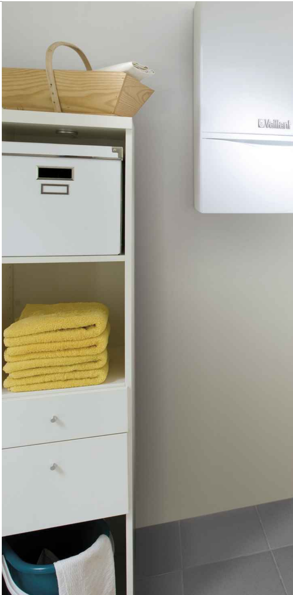
Calefacción y ACS
