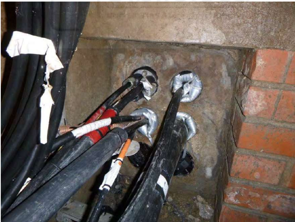
Figura 53: Vista de los conductos del interior de la cámara
