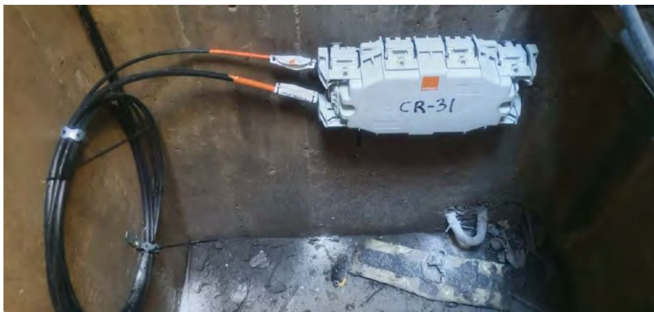
Figura 52: Caja terminales ópticas cerrada
