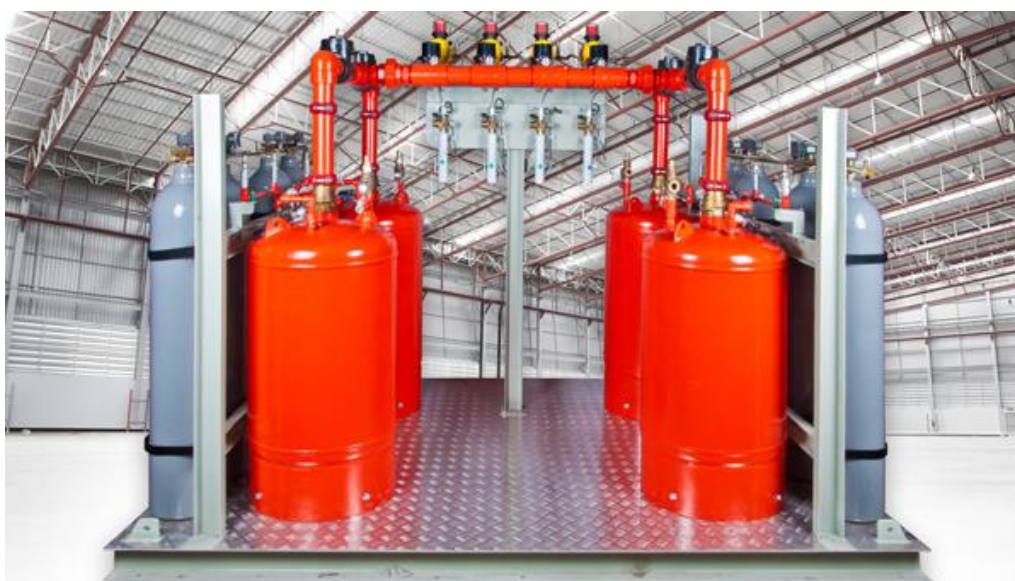
Figura 16: Sistema fijo de extinción por polvo
