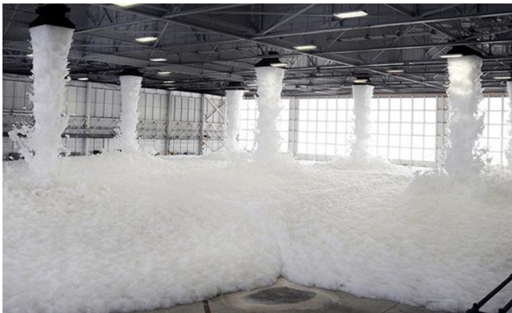
Figura 15: Sistema de extinción por espuma física
