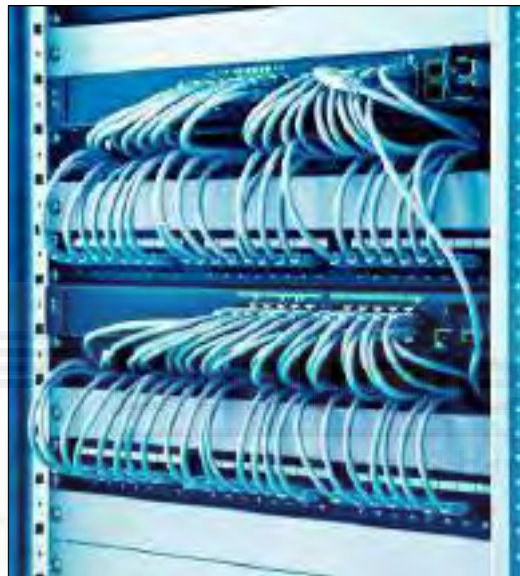
Figura 23. Conexión de un rack de comunicaciones.
