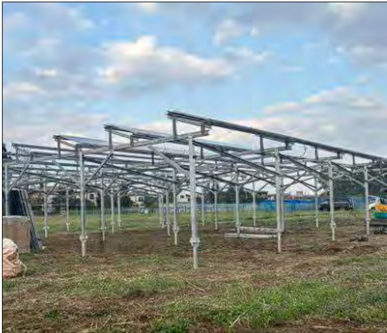
Figura 13.- Estructura para paneles solares.
