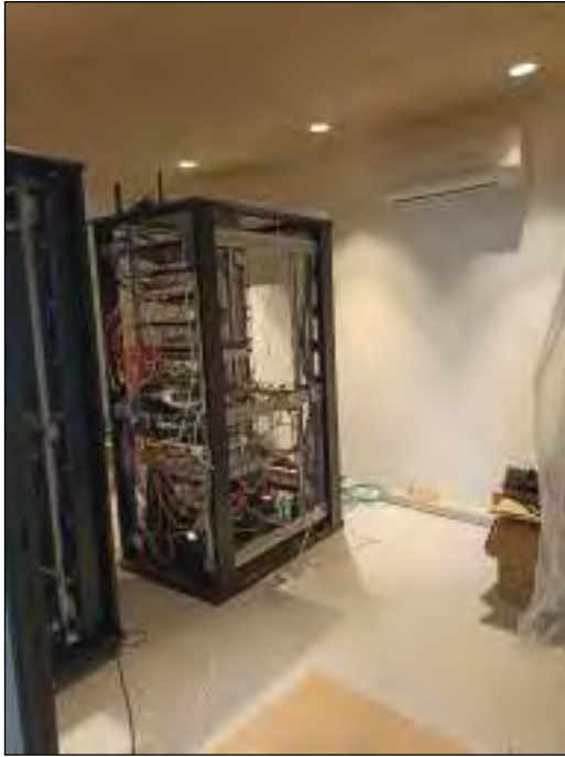
Figura 55.- Sala de centro de proceso de datos.
