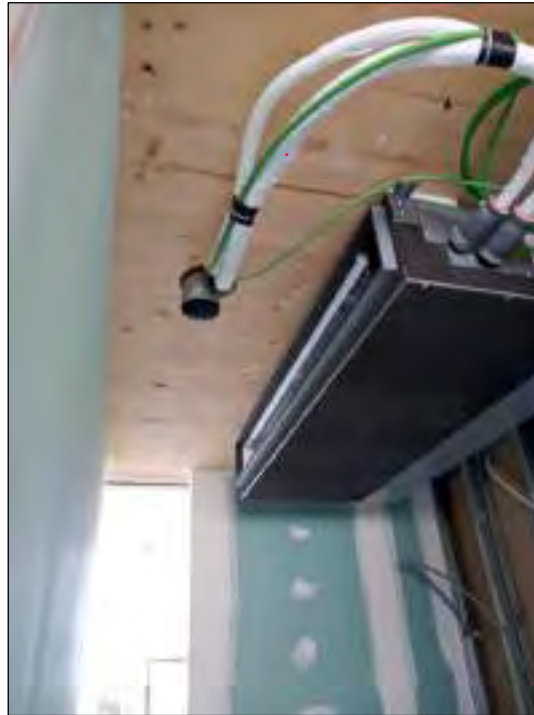
Figura 51.- Unidad interior en despacho de dirección.
