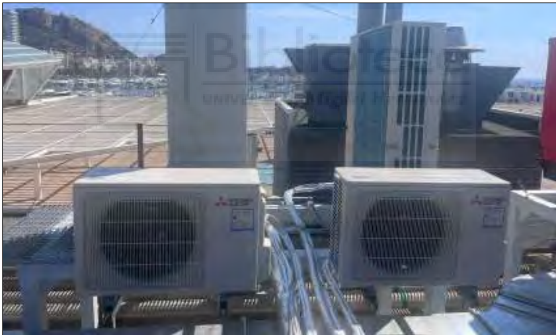
Figura 57.- Unidades exteriores de equipos de sala CPD.
