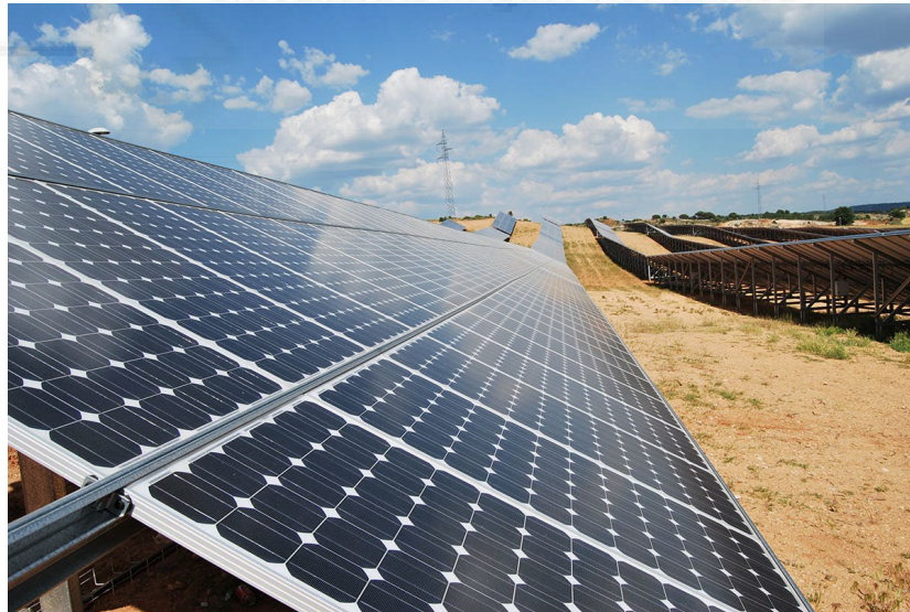
Figura 17 Generador fotovoltaico. Fuente: Ecenergia
