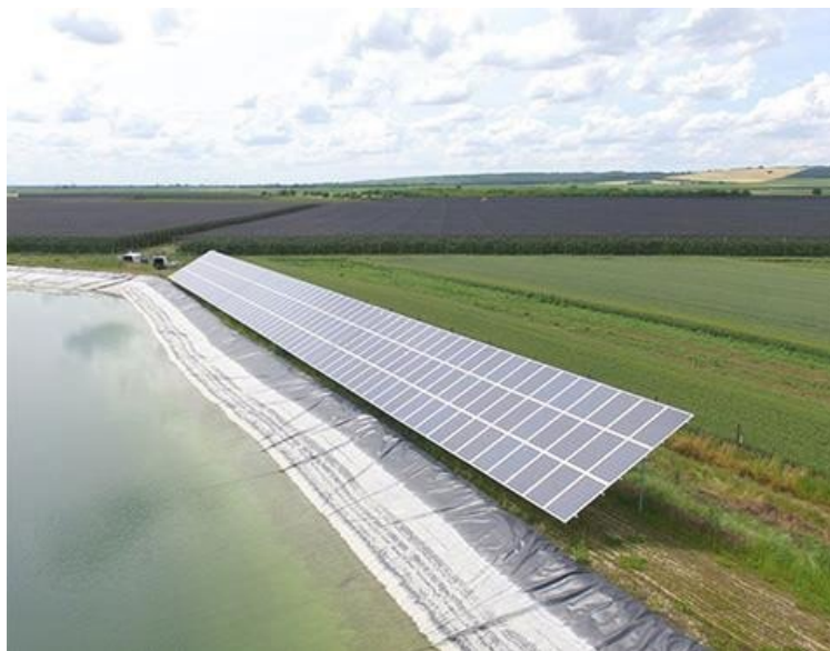
Figura 13 Módulos fotovoltaicos instalados cerca de embalse. Fuente: Tonkasolar
