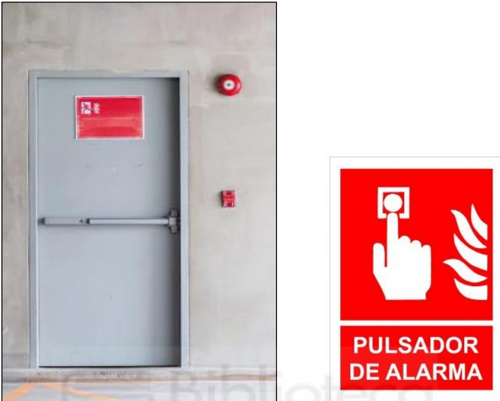
Figura 20. Pulsador de alarma de incendio sin señalización en sótano y tipo de cartel a colocar.
