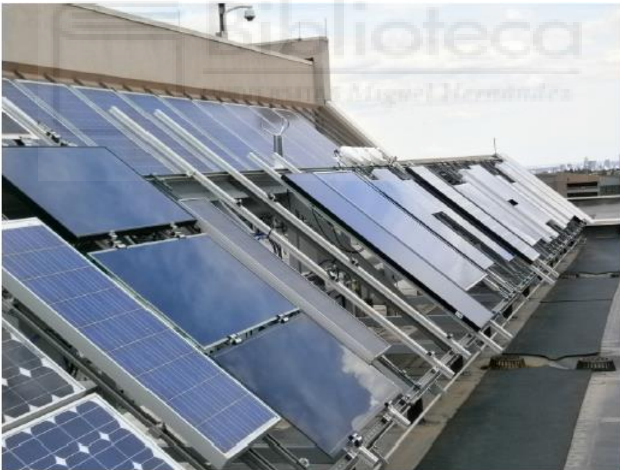
Ilustración 7: Equipamiento fotovoltaico Golden.
