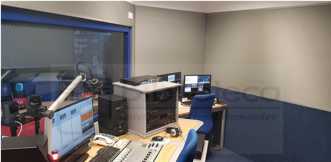
Ilustración 31 Vista general de la sala de control de Radio
